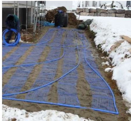
Bodennahe Flächenkollektor einer Sole-Wasser-Wärmepumpe
